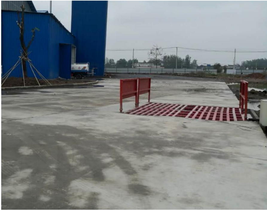
车辆冲洗设施
