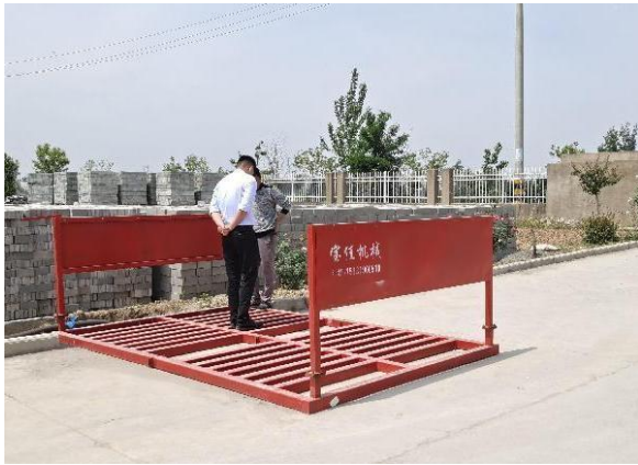
出入口车辆冲洗设施
