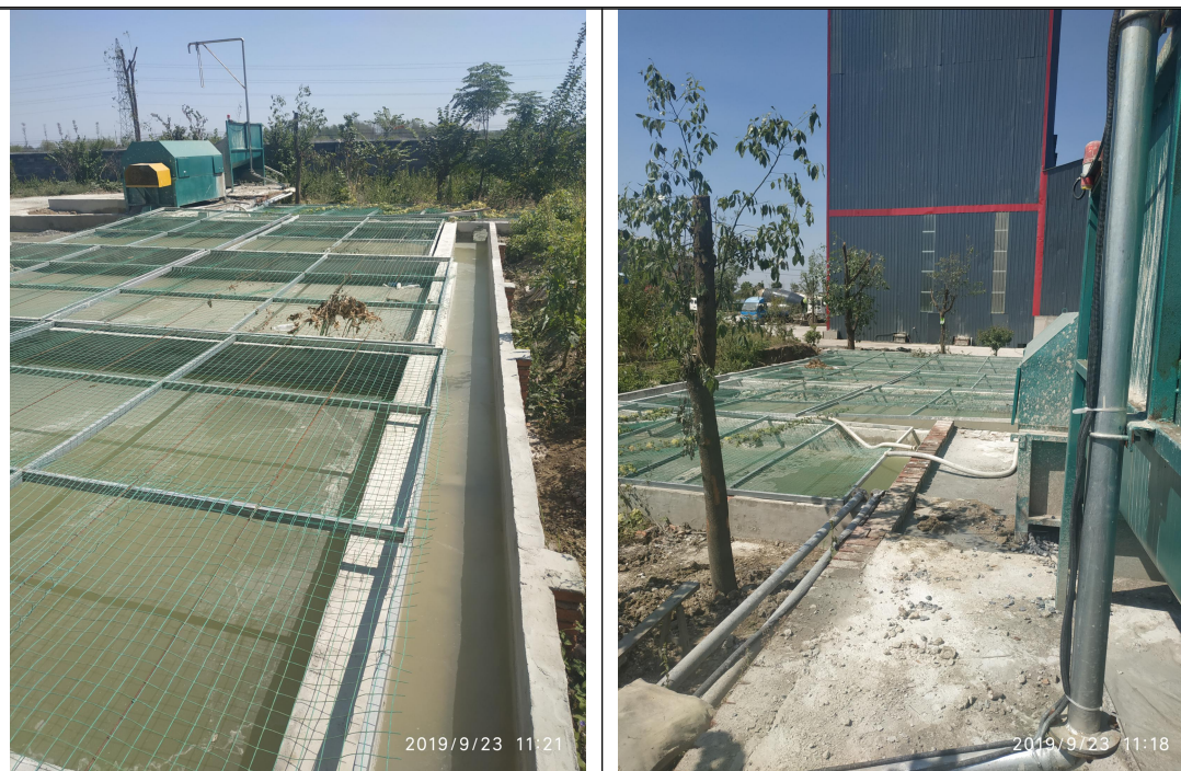
冲洗废水三级沉淀池
