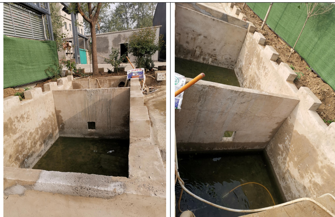
车辆冲洗废水三级沉淀池（兼顾初期雨水池）
