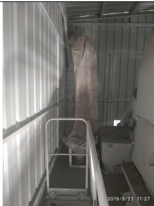
搅拌楼布袋除尘器
